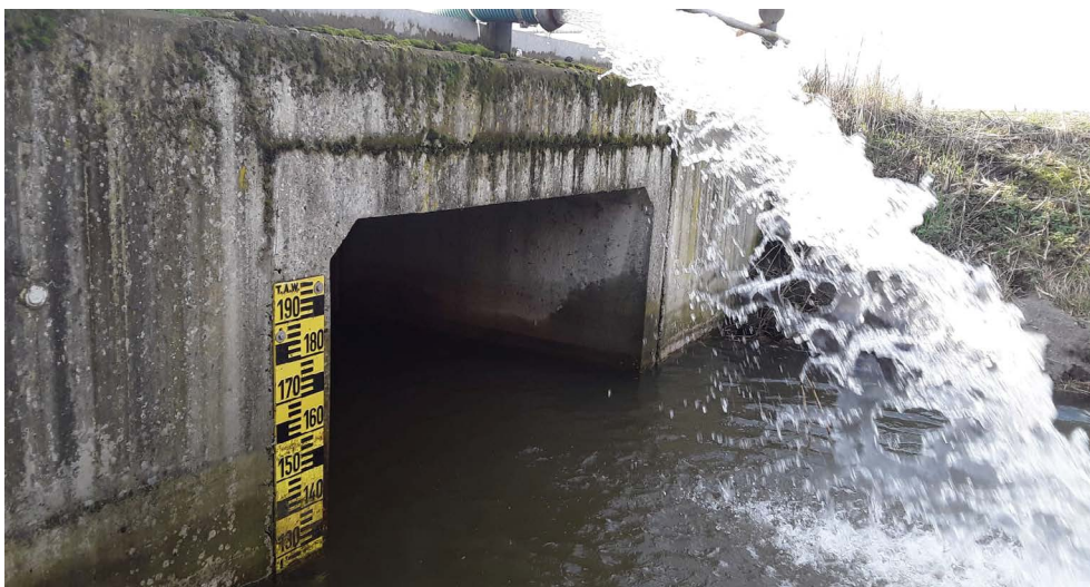
Waterpomp Rietveld Kallo – januari 2020
